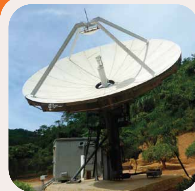
Trạm Teleport tại Hòa Bình
